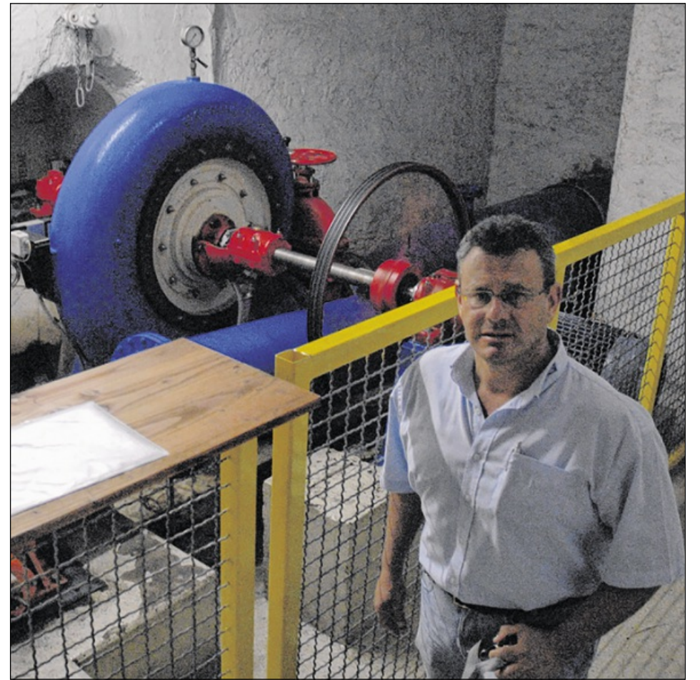
MARTIN WEINGÄRTNER – hier vor dem bestehenden Wasserkraftwerk in seiner Firma – hat mit der Geroldsauer Mühle viel vor. Foto: Kappler
