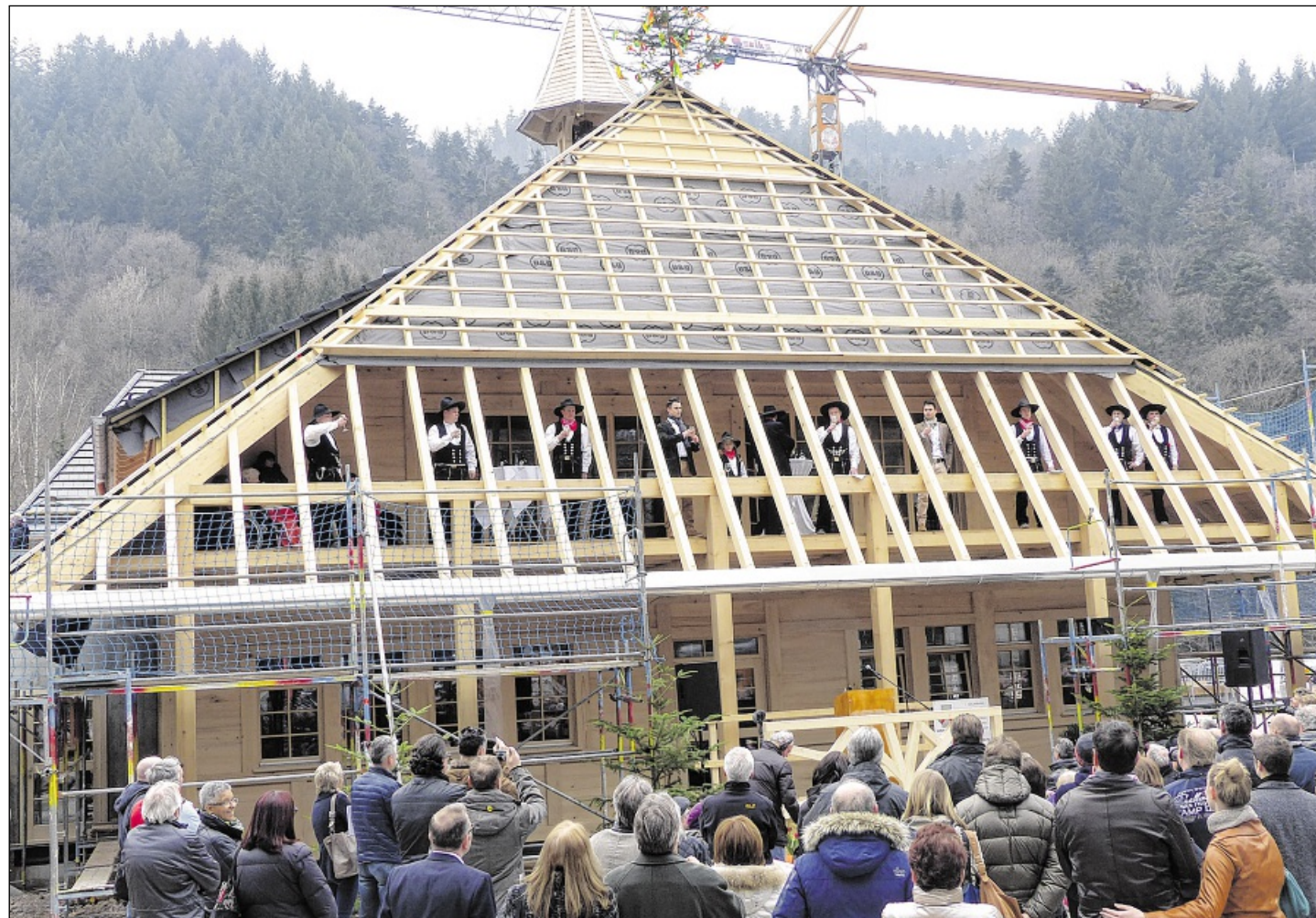
VIELE GÄSTE lockte das Richtfest der Geroldsauer Mühle an. Die Zimmerleute haben in den vergangenen Monaten 12 500 laufende Meter Weisstanne für die künftige Marktscheune verarbeitet. Foto: Krause Dimmock
