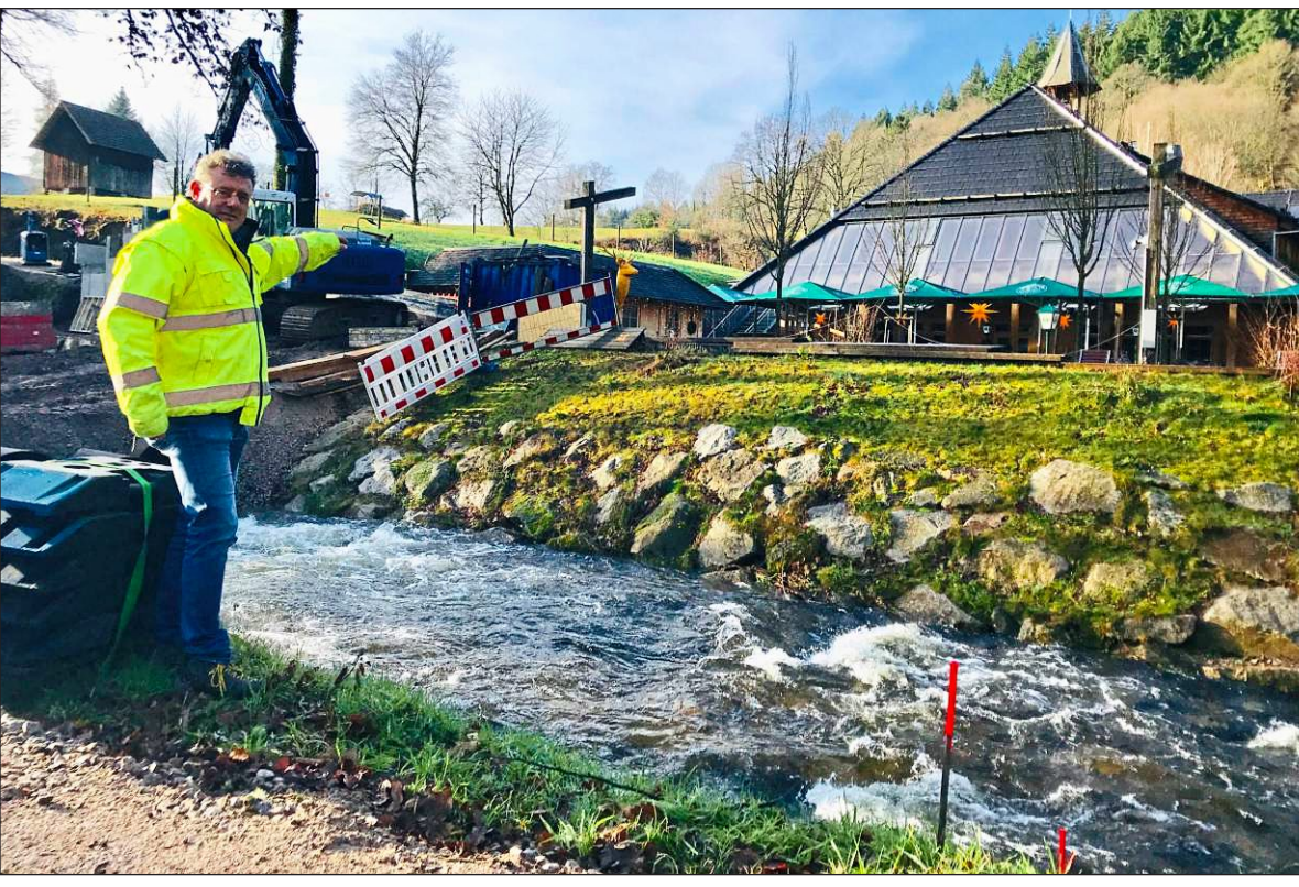
EINE NEUE ANSICHT bekommt die Geroldsauer Mühle. Am Grobbach wird bald das rund drei Tonnen schwere Wasserrad aufgebaut. Fotos: Kamleitner
